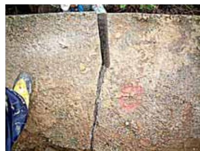
コンクリート破壊状態
